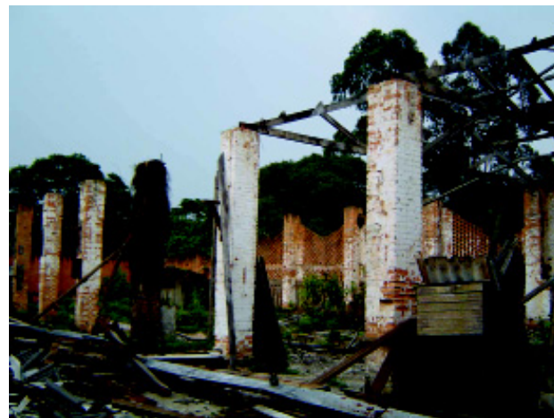
Parte da construção está condenada
